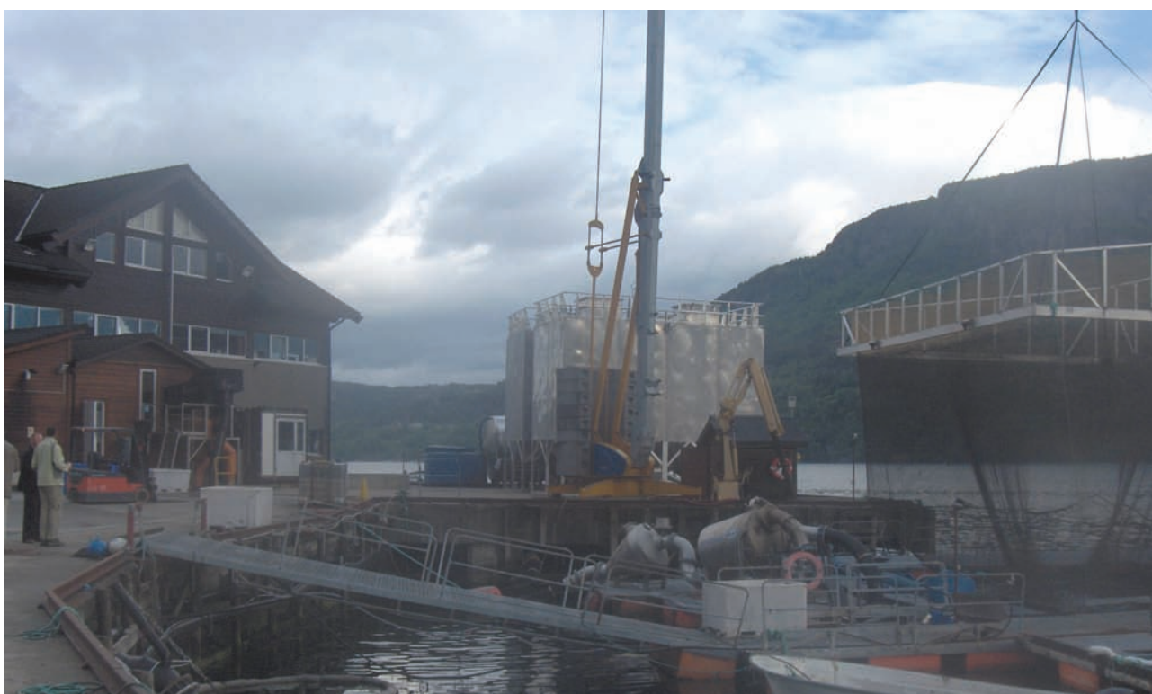
Figur 19. Slakteri B. Fisk trenges ved at slaktermerden heises opp i en kran. Vakuumpumpen er plassert på flytebrygge tett ved. Avsiling og overføring til adferdskaret som er synlig i svart utenfor veggen av slakteriet.
